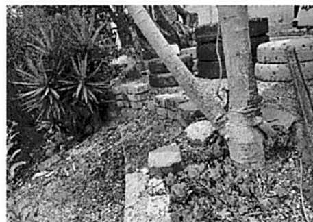
Foto 4: Elaboración de muro de contención, para evitar que se siga derrumbando el terreno
